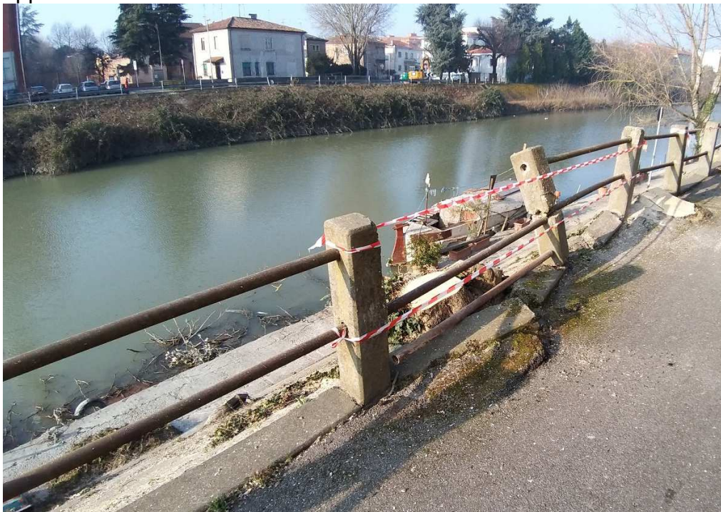
Foto 6 – Albero che danneggiava le difese idrauliche
