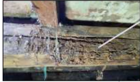
DEGRADO DI UNA TRAVE SECONDARIA
