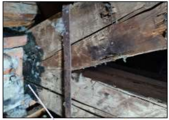
DEGRADO DELLA CAPRIATA LIGNEA
